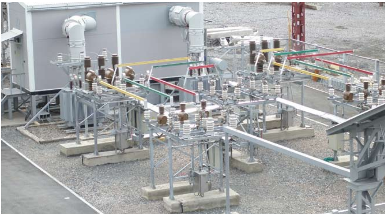
ОРУ 35 кВ с оборудованием на типовых блоках
